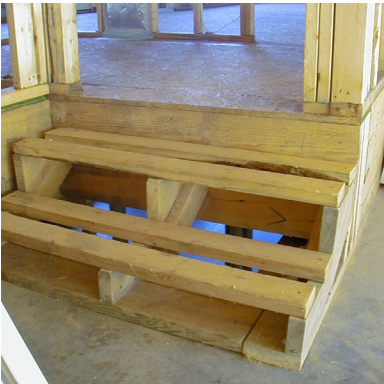
INCORRECTO: desvío de aire detrás de las escaleras
