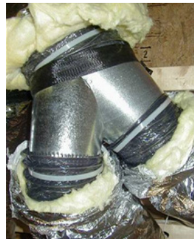
INCORRECTO: cinta UL-181 sin masilla
