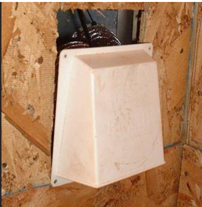
INCORRECTO: penetración del revestimiento sin sellar
