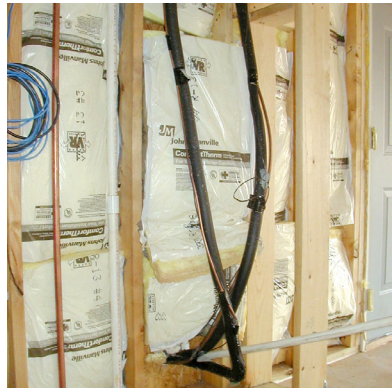
INCORRECTO: compresión/cobertura débil
