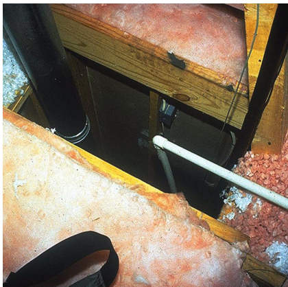
INCORRECTO: ducto no sellado
