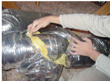
INCORRECTO: sin masilla
