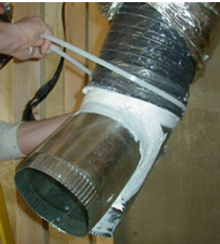
CORRECTO: juntas selladas con masilla
