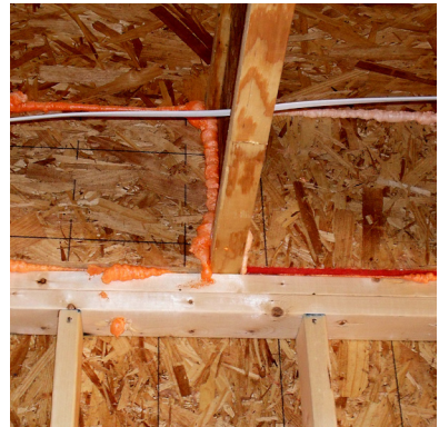
CORRECTO: cavidades de las viguetas bloqueadas
