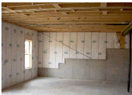
INCORRECTO (CZ3-4): aislamiento no en la parte del encofrado de hormigón de la pared del sótano
