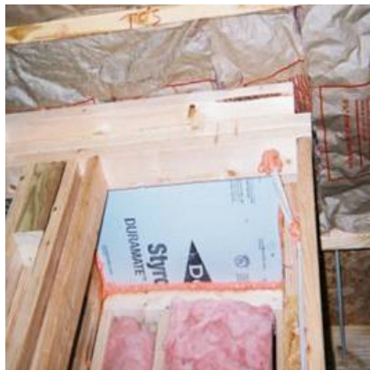
CORRECTO: ducto bien sellado
