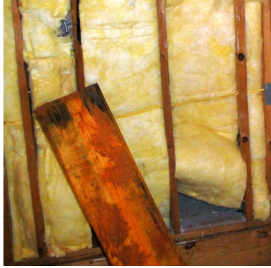
INCORRECTO: cavidad no rellena
