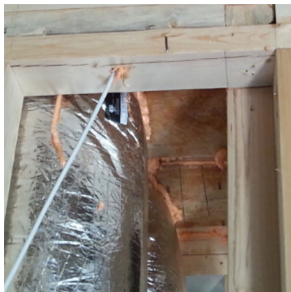
CORRECTO: ducto con tapa sellado de manera adecuada
