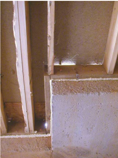
INCORRECTO: huecos en el revestimiento
