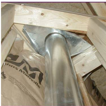
INCORRECTO: ducto mal tapado
